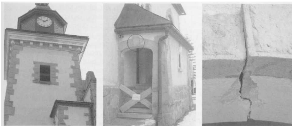
Rys. 8. Ciche-Miętustwo – kościół; uszkodzona dzwonnica, wejście boczne z pękniętym nadprożem
