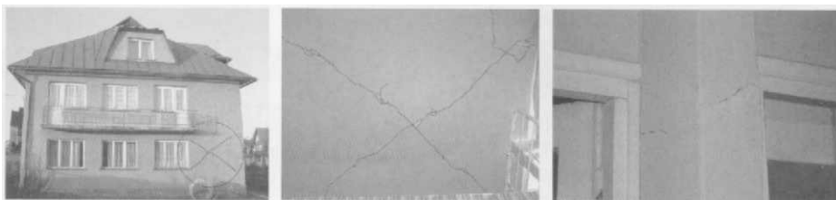
Rys. 9 Ciche-Miętustwo – dom parafialny; widok ogólny, zarysowania ukośne ściany zewnętrznej – tzw. krzyż św. Andrzeja, pęknięcie ściany działowej
