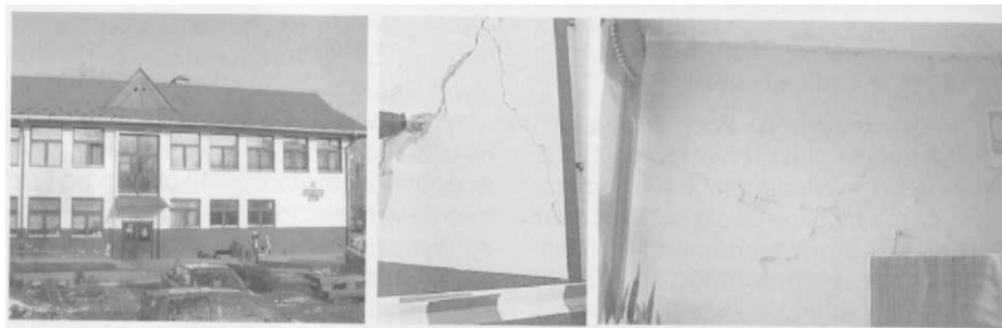
Rys. 6. Skrzypne – budynek Zespołu Szkoły Podstawowej i Gimnazjum; widok ogólny, uszkodzona ściana szczytowa, zarysowania ukośne ściany działowej
