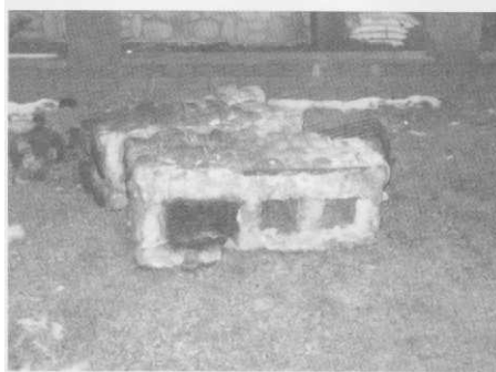
Rys. 10. Uszkodzenia kominów i komin, który spadł na ziemię
